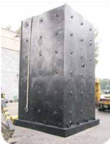
Pompownia - zbiornik w systemie PE - beton - PE
