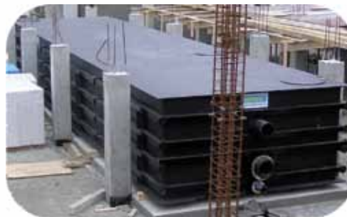
Zbiornik buforowy wody basenowej
