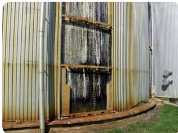
Wycieki powstałe w stalowym zbiorniku
